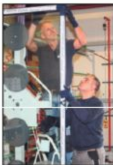
Kali Kamiran (rechts) baut gemeinsam mit Vorarbeiter Stephan Kelle die Scheibe in den Fensterrahmen.
